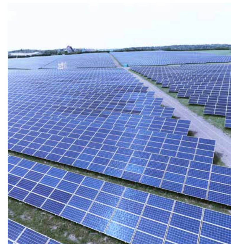
Et af Better Energys store projekter er anlægget i Glansager.
